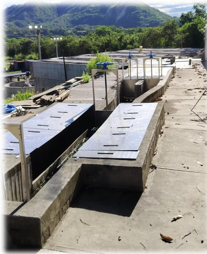
Foto 8. Planta de Tratamiento Agua Potable
